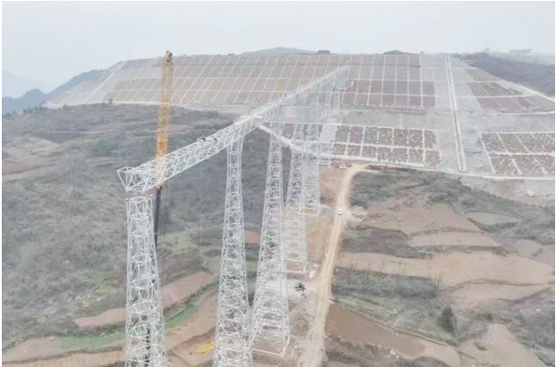
德江机场北端灯光铁塔。
