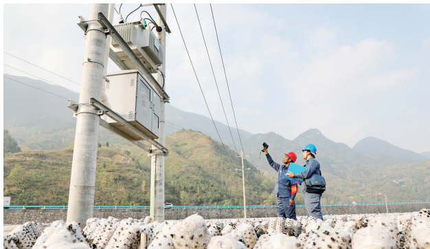
2024年11月7日,在印江土家族苗族自治县合水镇兴旺村黑木耳种植基地,供电人员对该基地抽水专变进行红外测温,保障供电设备健康运行。 向世杰 摄
