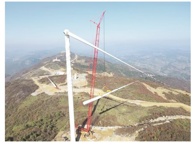
沿河自治县晓景乡中寨风电场风力发电项目基地。
