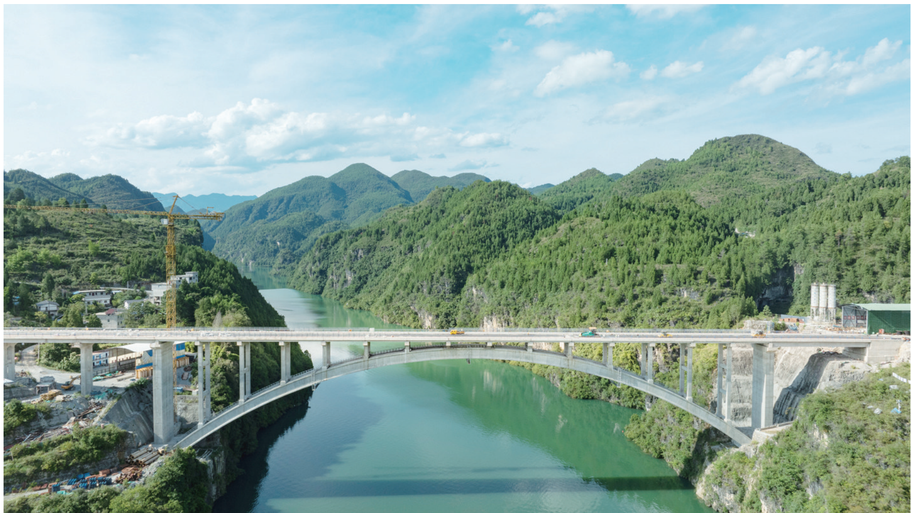
9月16日，铜仁夹石特大桥进入路面铺油阶段，力争国庆前夕全面完成实现两地通车。
