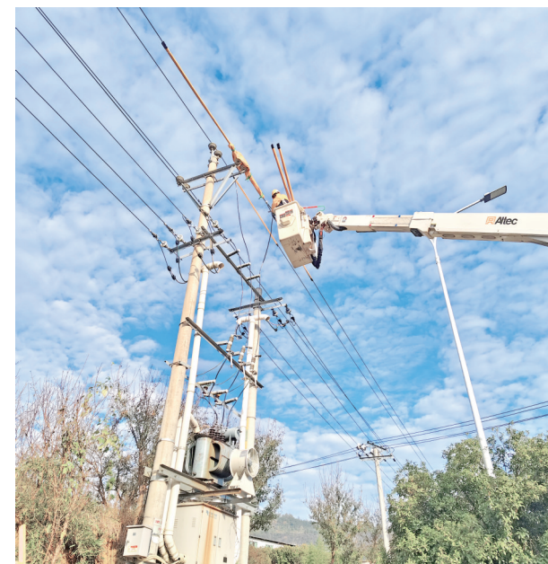
南方电网江口供电局通过低电压与过载治理工作,切实保障群众迎峰度冬期间安全高效用电,进一步提升用户用电满意度。
