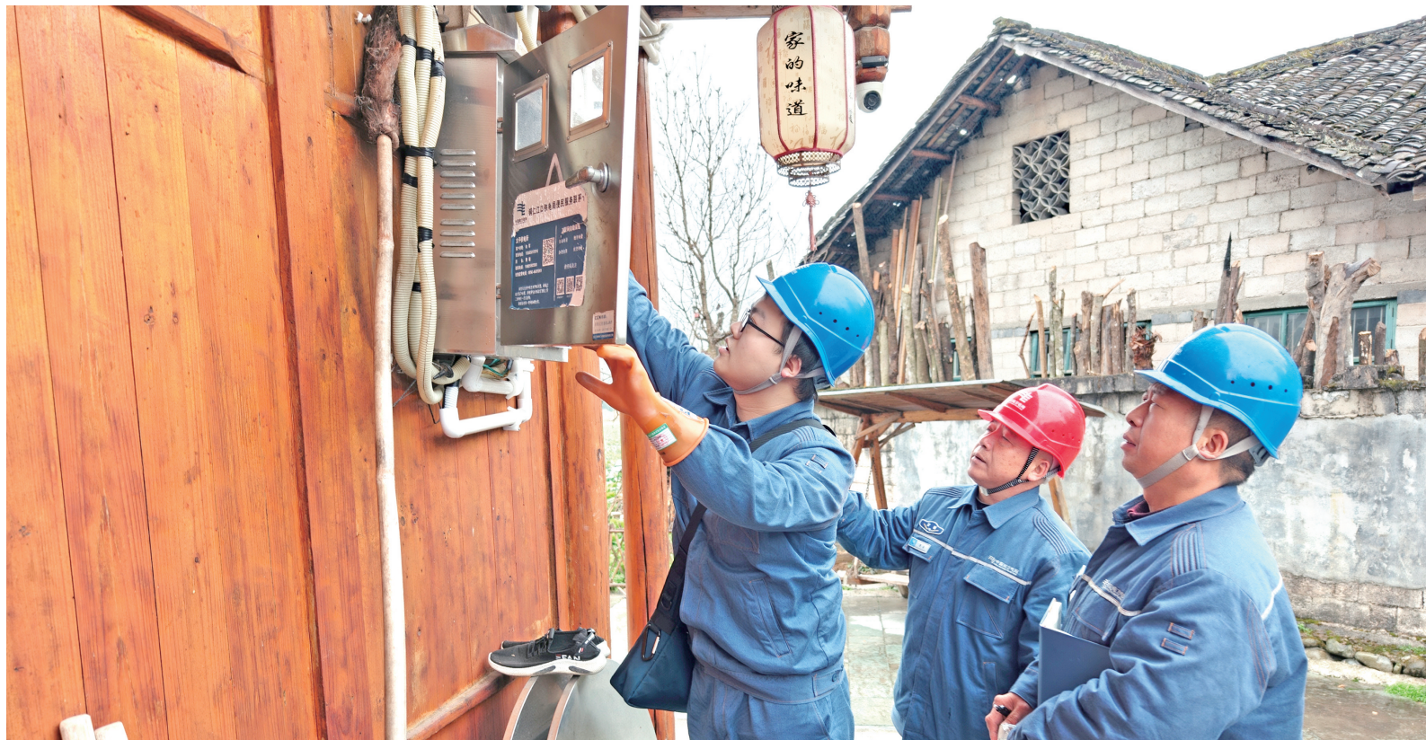
近日,江口供电局开展用电检查,对景区民宿、宾馆线路老化、配电箱锈蚀等故障进行排查,保障春季安全稳定用电。吴瑾 摄
