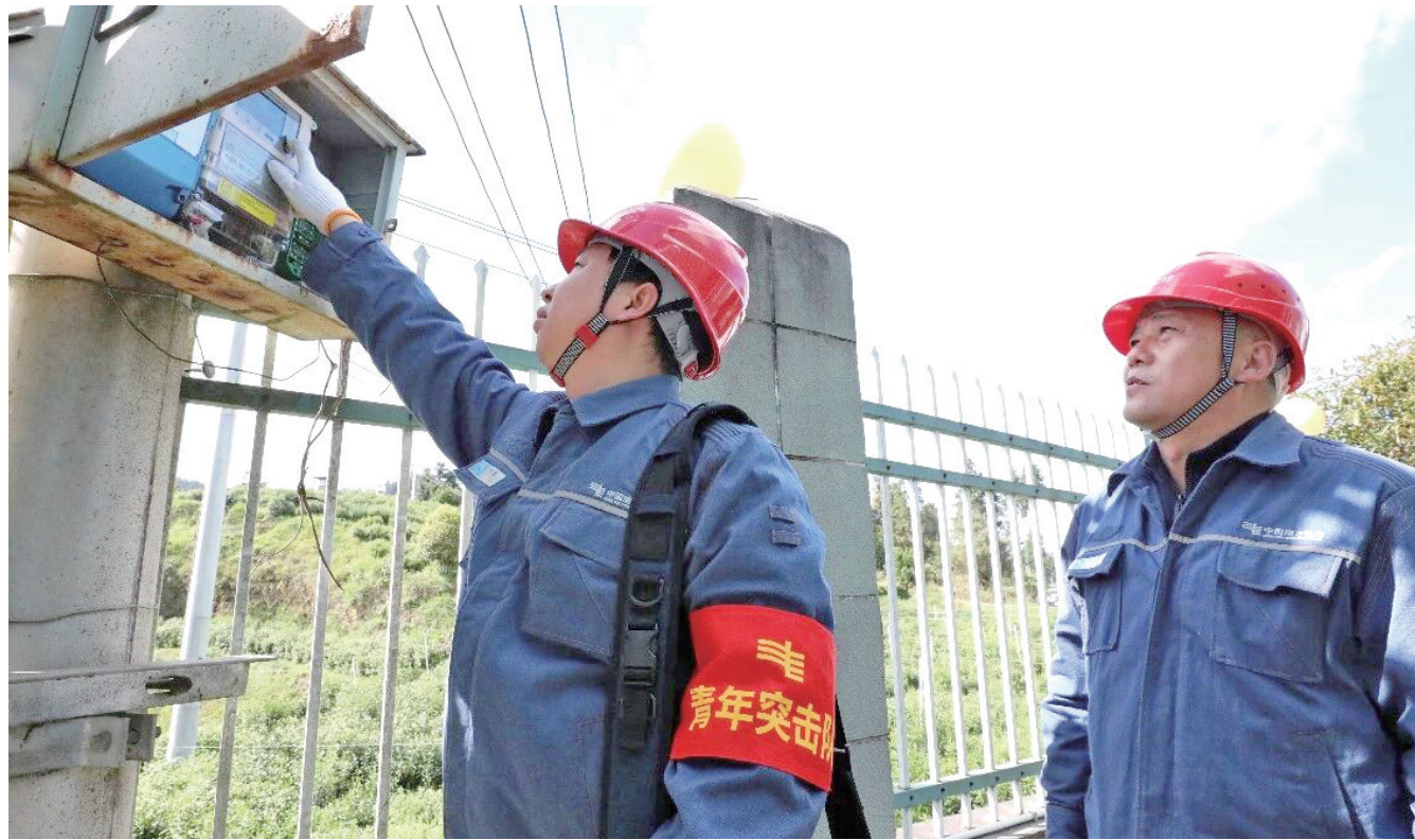
当下,春茶采摘加工进入旺季,茶叶加工用电需求持续攀升。江口供电局组织青年骨干、党员服务队组建专项保电队伍深入全县茶企生产加工车间,开展保供电上门服务与用电安全排查,以可靠电力护航全县茶产业稳产增收,为县域特色经济高质量发展注入强劲“电力”。 黎福慧 杨康 摄
