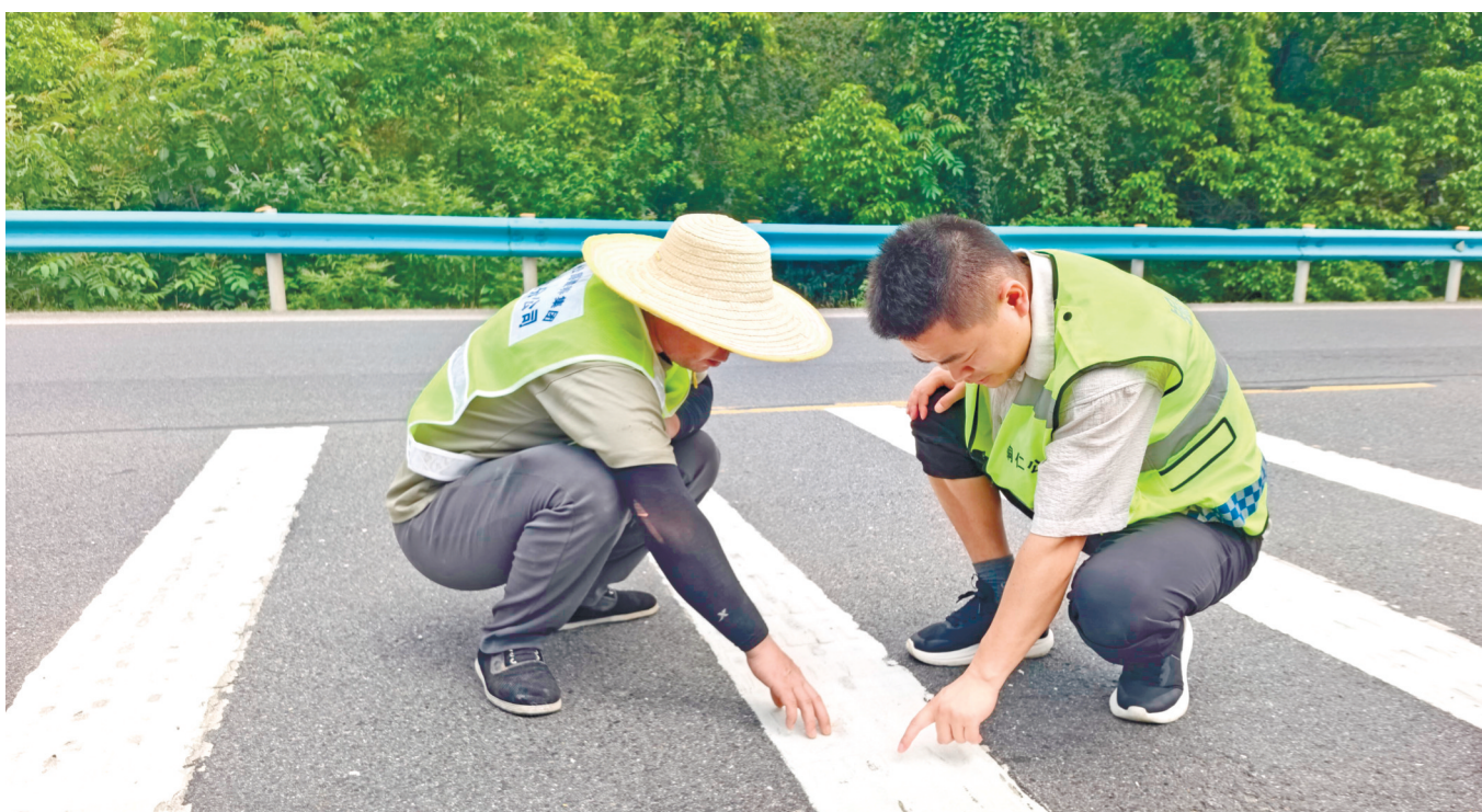
工作人员查看震源减速标线磨损情况。
